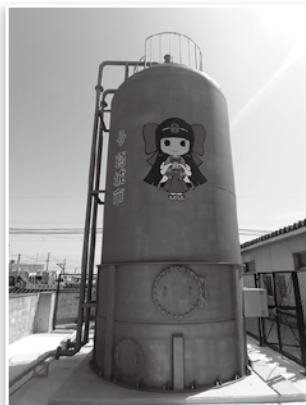
▲耐震性の貯水槽
