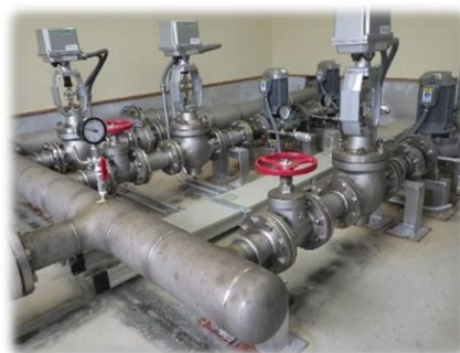
◇小水力発電【新庄浄水場】◇
