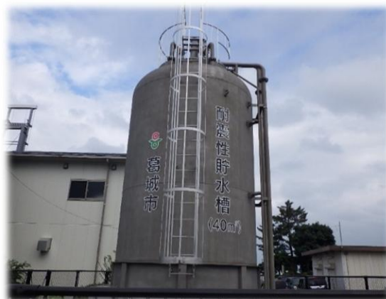
◇耐震性貯水槽◇
