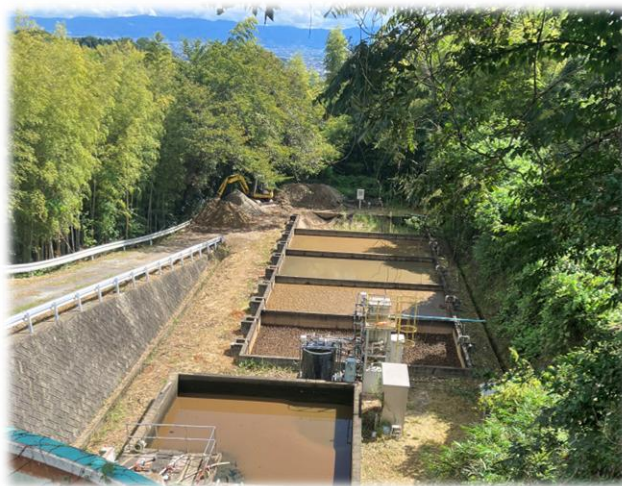
◇排水処理施設【竹内浄水場】◇
