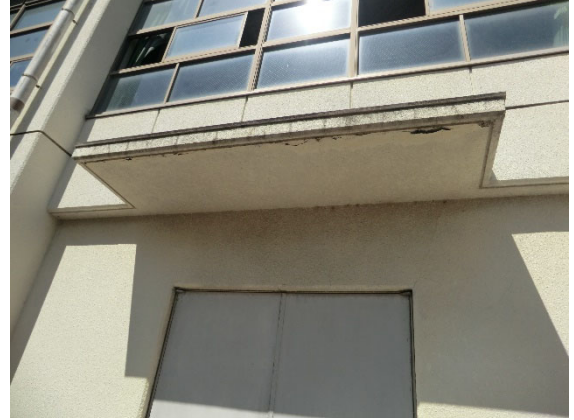
道路に面する1階底部分に爆裂
