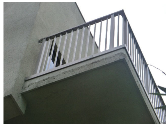
屋外階段の打ち継ぎ部にクラック
