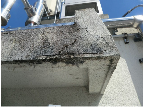
屋上の底部分に爆裂
