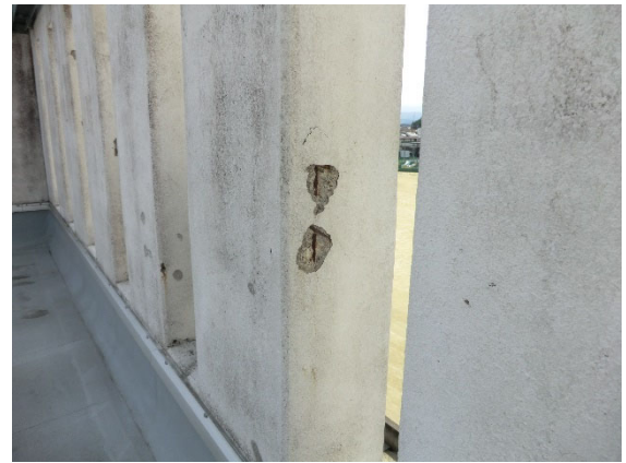
屋上（校舎入り口上部）に爆裂
