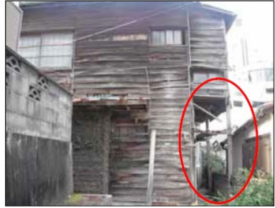
柱に局所的な亀裂やひび割れ等がある例 （柱、はり、筋かい、柱とはりの接合）
