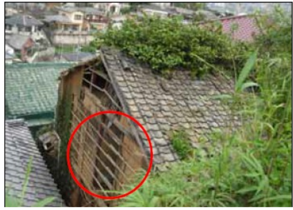
外壁の仕上げ材料が剥落、腐朽又は破損 し下地が露出している、 壁体を貫通する穴がある例（外壁）
