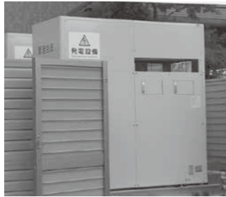
◀コージェネレーションシステム
