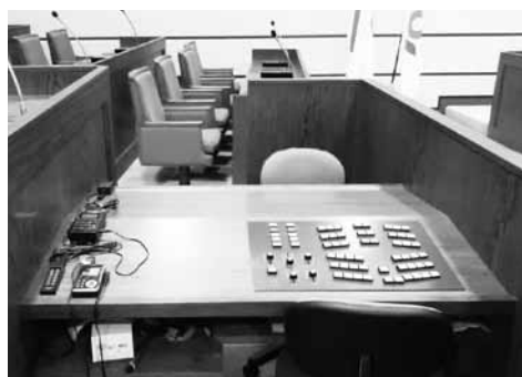
▲議場音響設備
