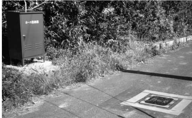
▲新設された消火栓
