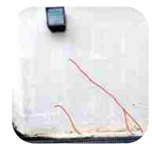
外壁のひび割れ
