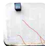
外壁のひび割れ
